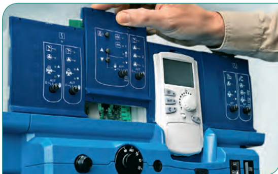
2 Regelelektronik in Modulbauweise
