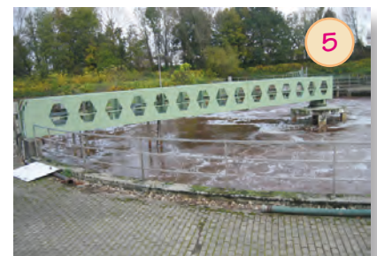
5 Belebungsbecken: Wasser wird bewegt und es wird von unten Luft eingeleitet.
