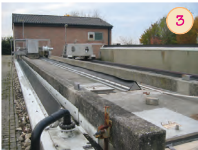
3 Sandfang: Hier sinkt der Sand nach unten und wird durch eine Pumpe abgesaugt.
