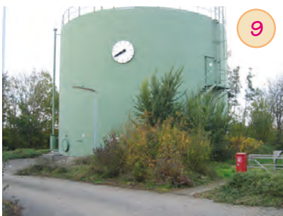
9 Gasbehälter: Hier wird das Klärgas gespeichert, um dann mit Gasmotoren Strom zu erzeugen.
