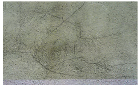
Rissbildungen im Putzsystem
