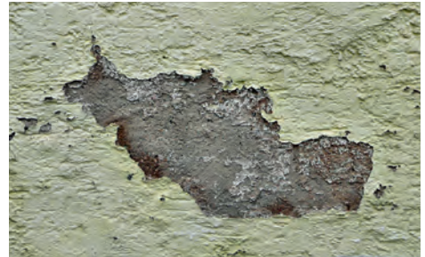
Abplatzungen von Putz- oder Anstrichschichten
