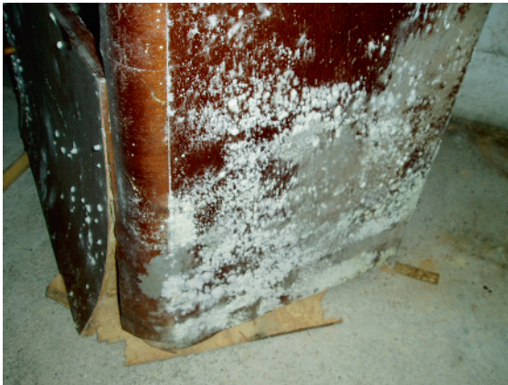
Abb. 1.1 Weiße Schimmelpilze auf feuchtem Möbelholz im Keller, nach einem Eindringen von Regenwasser.
