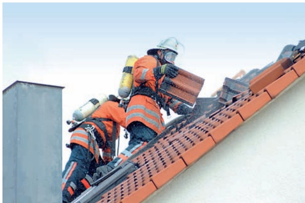
Bild 1: Nachlöscharbeiten nach einem Brandeinsatz (hier ohne Sicherungsmaßnahmen gegen Absturz)
